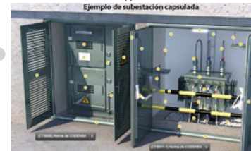
Gabinetes (para transformadores)
